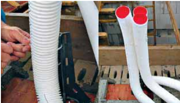
Abbildung 13: Lüftungsrohr am Umlenkstück installiert
